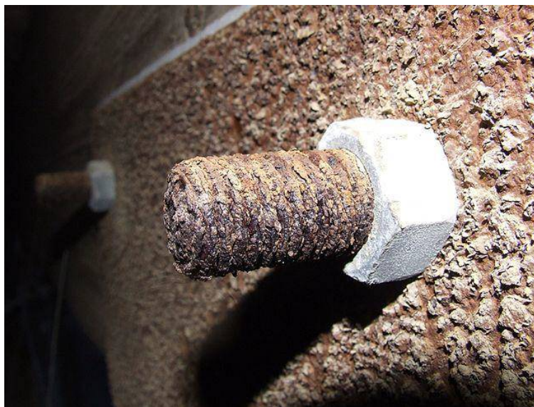
Рисунок 6. Коррозия стальных изделий
